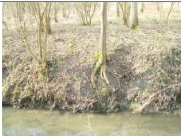
Fragilisation des berges et racines mises à nue après le curage
